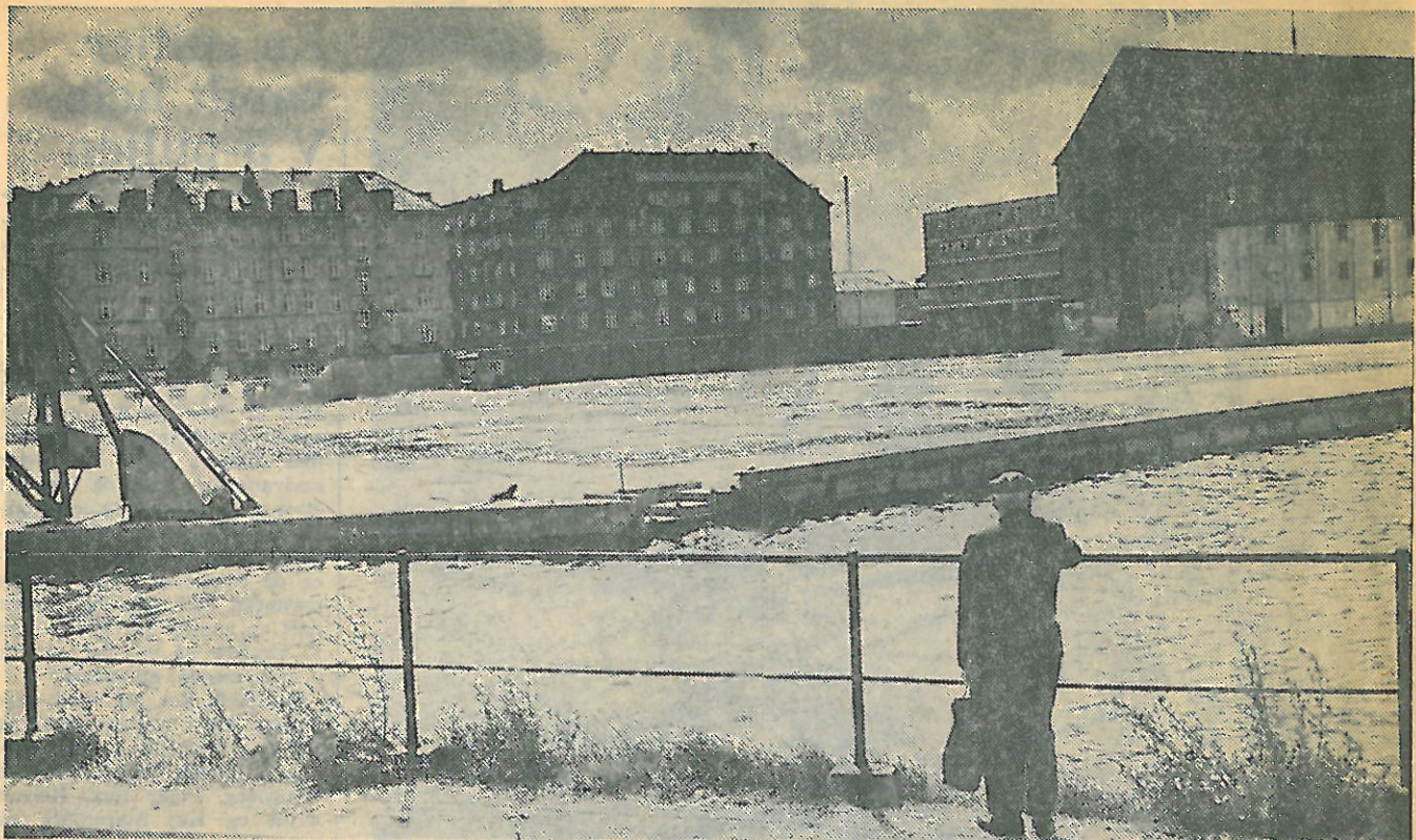
Dansk Totalentreprise har nået at rydde al bebyggelse på Islands Plads, bortset fra det bevaringsværdige pakhhus, hvor der efter det første projekt skulle indrettes små lejligheder. I kanalen foran skulle der indrettes lystbådehavn for at understrege det fashionable præg på projektet. (Foto: Erik Petersen).
