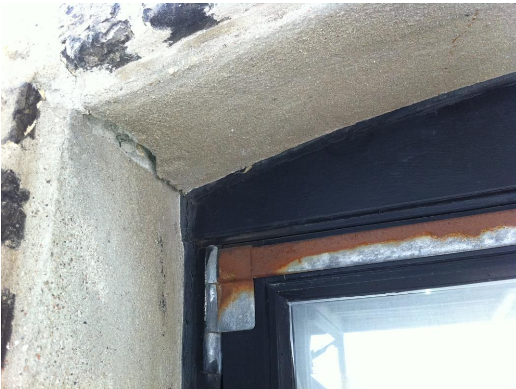
Generelt er puds i vinduesfals i dårlig forfatning. Ligeledes er beslag og træværk Nedbrudt og stærkt misvedligeholdet.
