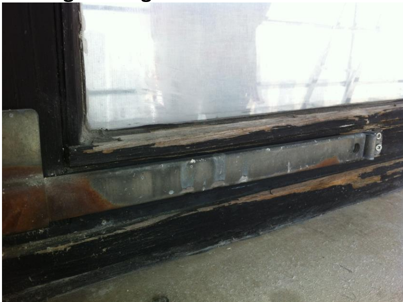
Her ses eksempel eksisterende vinduers tilstand.
